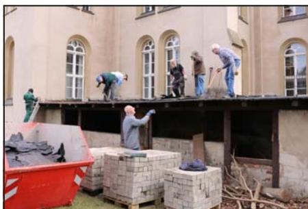
Mit einem Arbeitseinsatz zum Wegriss des alten Kohleschuppens hinter der Kirche haben die Umbauarbeiten begonnen
